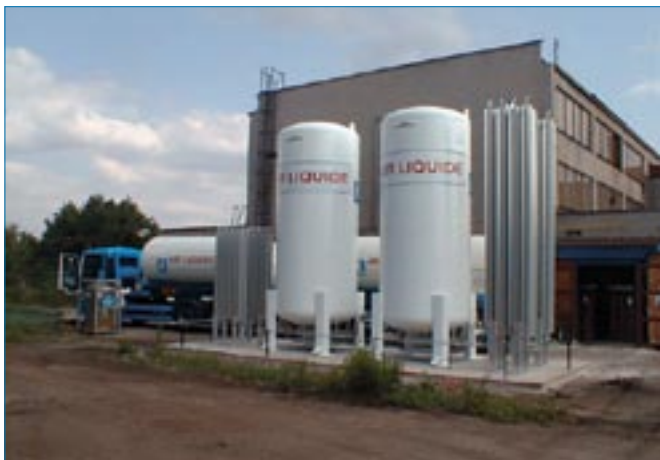
Plnění stacionárních kryogenních zásobníků
